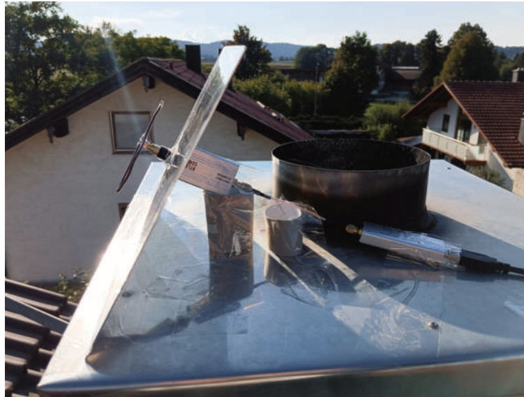
Abbildung 14: Antenne montiert auf dem Kamin
